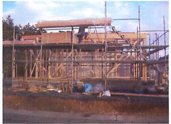
南三陸町歌津・吉野沢仮設集会所建設状況 すばらしい歌津をつくる協議会撮影 平成24年2月
