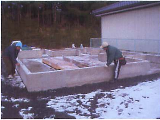
南三陸町歌津・吉野沢仮設集会所建設状況 すばらしい歌津をつくる協議会撮影 平成24年2月
