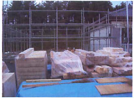
南三陸町歌津・吉野沢仮設集会所建設状況 すばらしい歌津をつくる協議会撮影 平成24年2月
